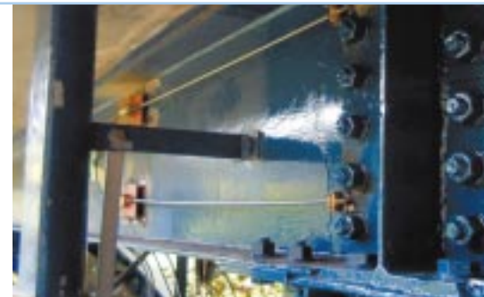
Cordes optiques montées sur la poutre principale du pont.
