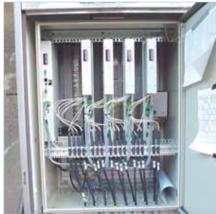
Station de monitoring reliée au serveur Internet OSMOS.
