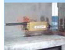
Extensomètre sur un joint de dilatation.
