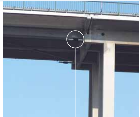
OSMOS-WIMS est installé sur le Viaduc de Murrthal (Voir p4) Ci-contre, un des palpeurs optiques du WIMS.
