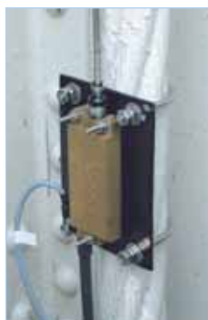
Extensomètre optique - Détail.
