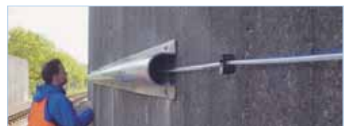
Corde optique de 10 m sur une section courbe.
