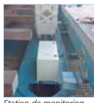
Station de monitoring connectée au serveur Internet OSMOS
