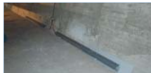
2 cordes optiques de 2 m à l'intérieur d'un voussoir
