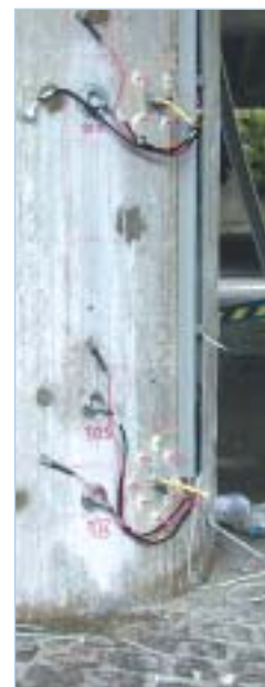
Hygromètres et capteurs de corrosion
