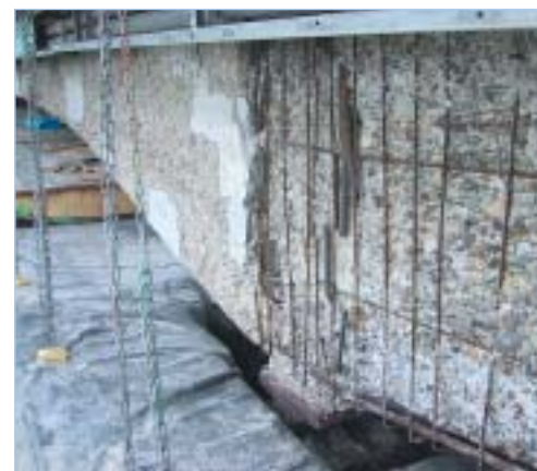
Zone de curetage avant réparation
