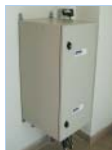
Station de monitoring pilotée par Internet sécurisé
