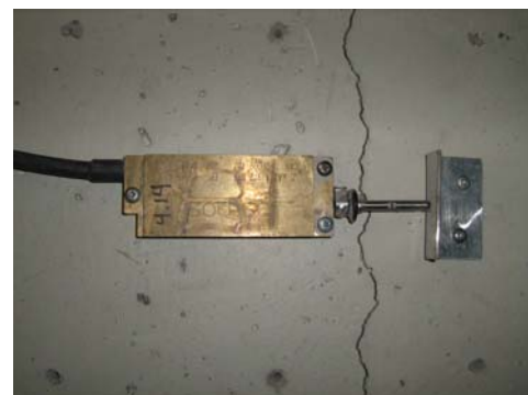
Extensomètre à Corde Optique fixé sur une fissure sur un mur de voûte
